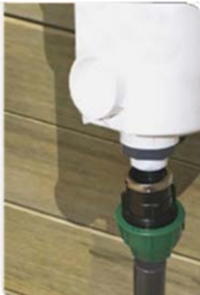
Starres abfallendes Rohr unter dem Skimmer
